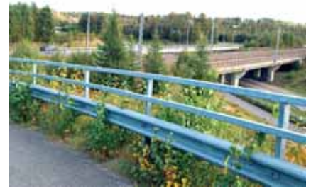
Noin 15 vuotta käytössä olleet teräsrakenteet.
